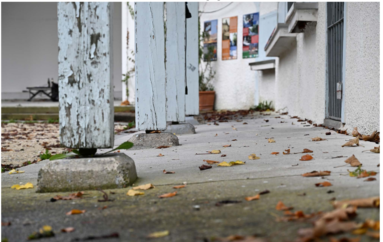
R 6.01 Vordach Stützen teilweise schwebend durch abgesenkte Bodenplatte
