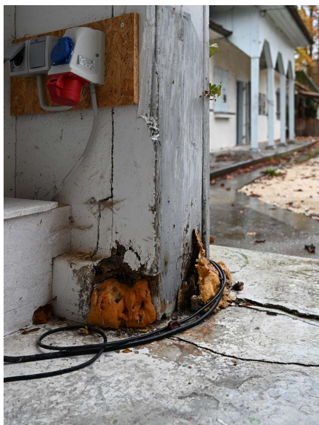
R 3.0 AVF: Schäden am Sockel und Bodenplatte
