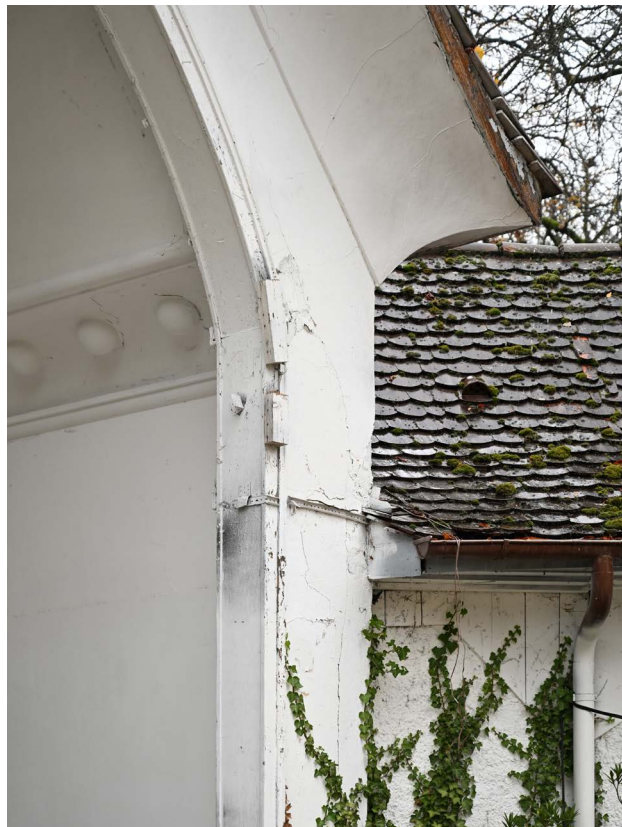
R 3.01 AVF: Verwitterungsschäden an Ecke
