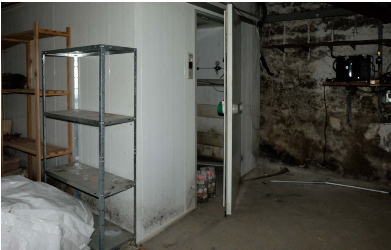
R 7.08 B/C: Blick auf Kühleinheit
