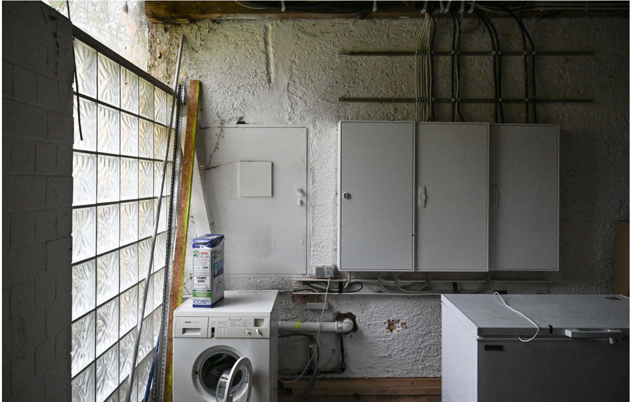
R 1.02 C: Stromkästen, Waschmaschinenanschluss
