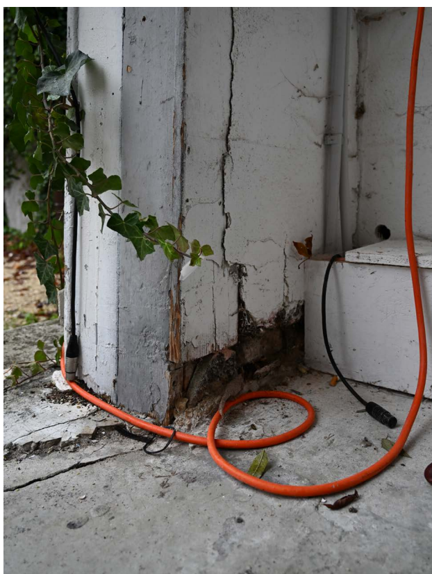
R 3.01 AVB: Schäden am Sockel
