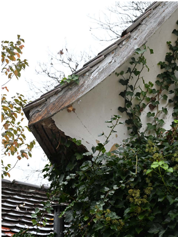
R 3.01 AVB: Traufe mit abgeplatzttem Putz
