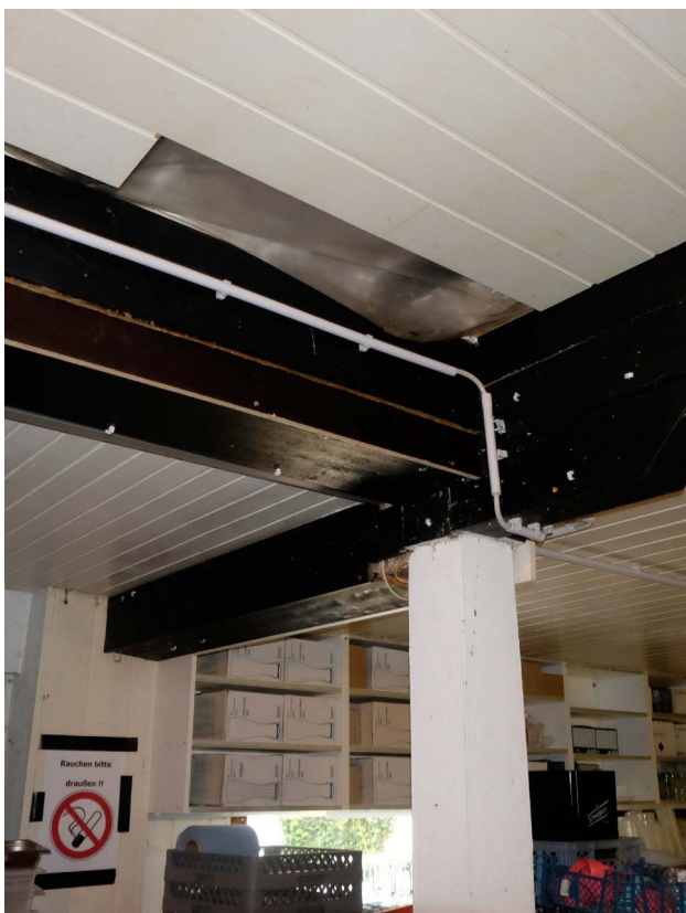
R 6.02: Deckenverkleidung teils offenliegend
