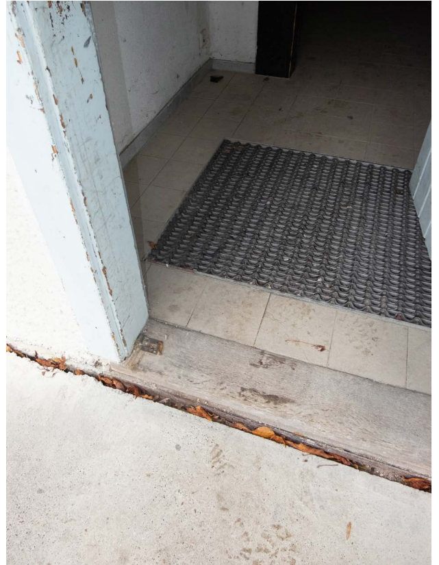
R. 6.01: Abstand durch Setzung vom der Bodenplatte des Eingangsbereichs außen
