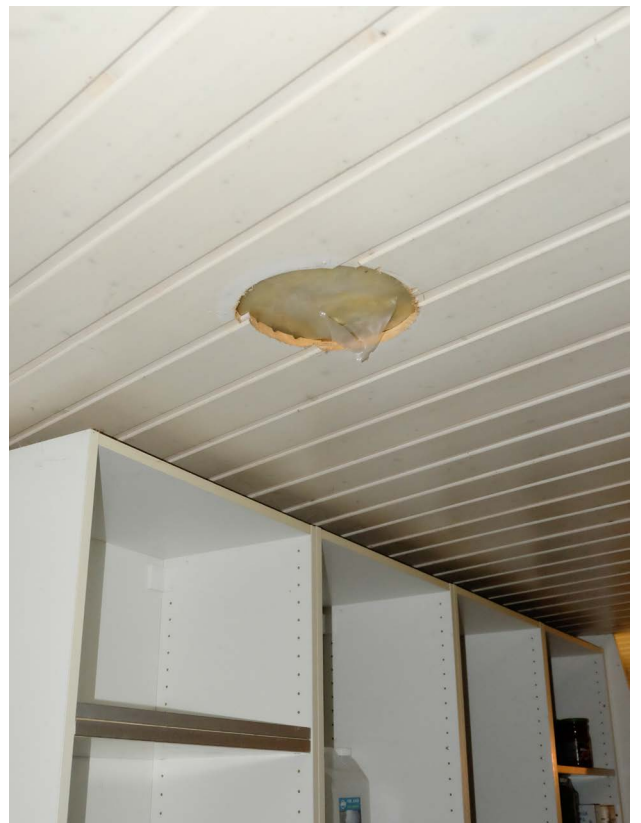
R 6.03: Öffnung in Decke mit sichtbarer Dämmung
